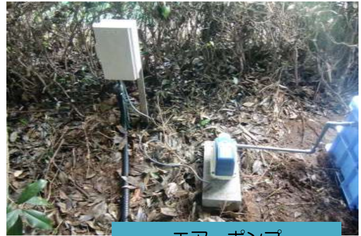
エアープンプ & コンセント
